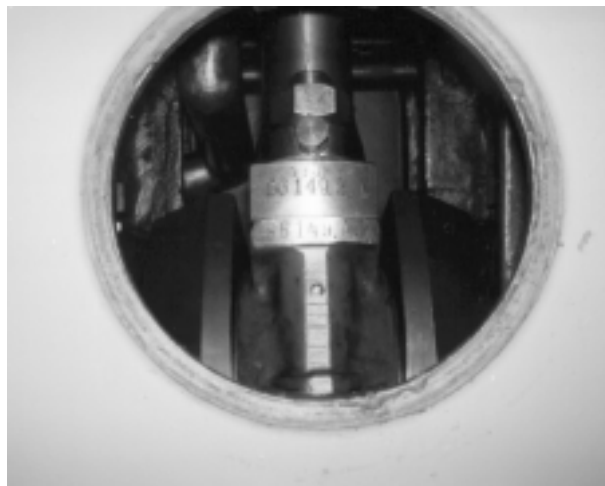
Innvendig: Bildet viser den innvendig tilstanden til motoren. Her er det rent og fint. Motoren har som nevnt et annet sted en total gangtid på under 10 timer. (Foto: Ole H. Jelstad)
